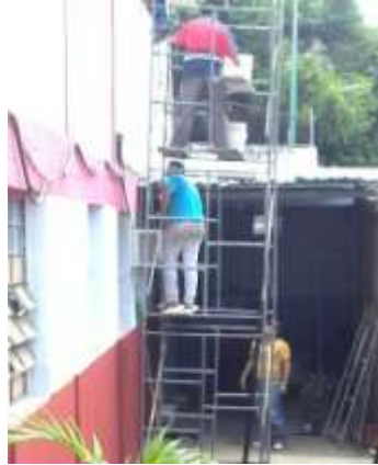
INSTALACIÓN DE TUBERÍAS DE 2 PULGADAS Y CAJETINES DE PASO PISO 1 Y 2 SIMÓN BO LIVAR
