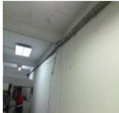
TUBERÍA 3 PULGADAS MATRIZ ELÉCTRICA PRINCIPAL VIA INTERNA DESDE TABLERO ELÉCTRICO IUNEP HASTA TABLERO PRINCIPAL CENTRO SIMÓN BOLÍVAR
