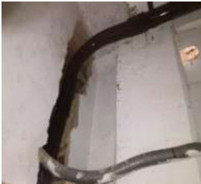
TUBERÍA 3 PULGADAS MATRIZ ELÉCTRICA PRINCIPAL DESDE TABLERO 1 IUNEP
